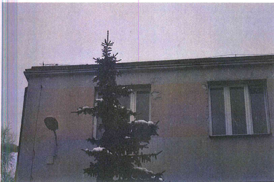
Fot. 2. Ubytki farby i tynku na elewacji budynku (liczne na całym obiekcie).
