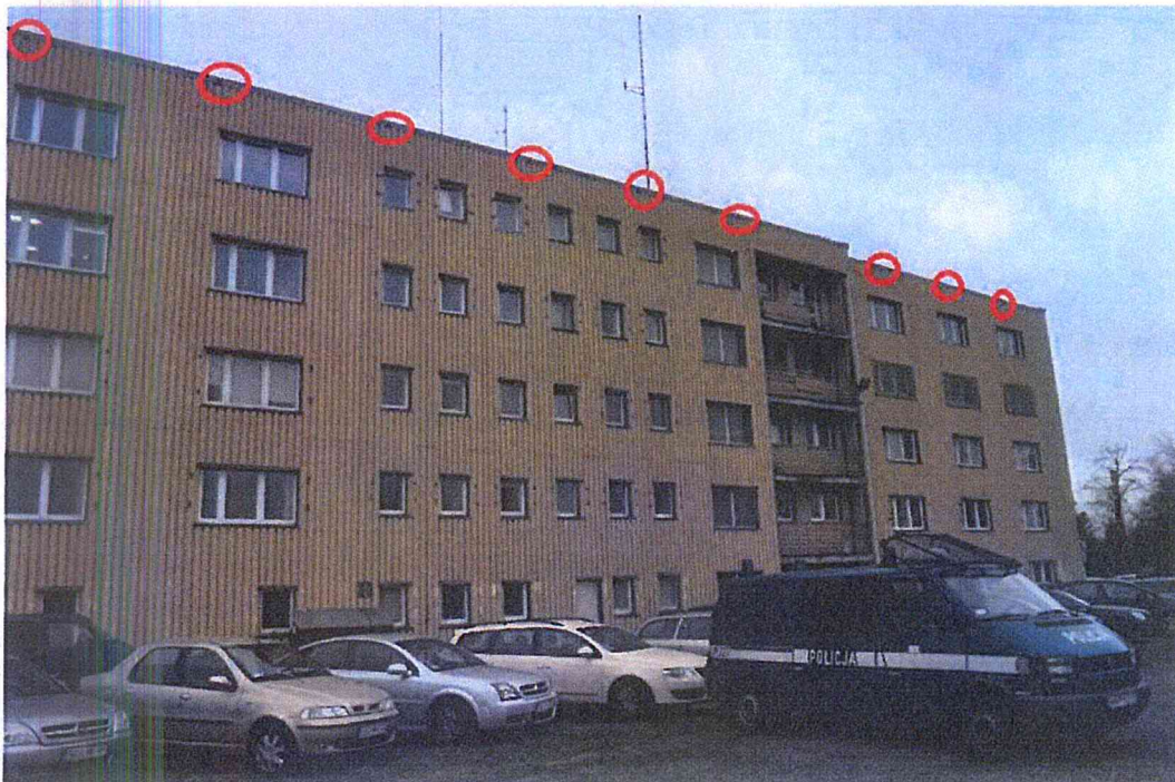
Fot. 3 i 4. Niezabezpieczone otwory wentylacyjne.
