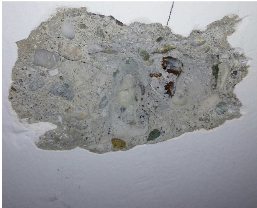
Zdjęcie 4 – Odkrywa zbrojenia
