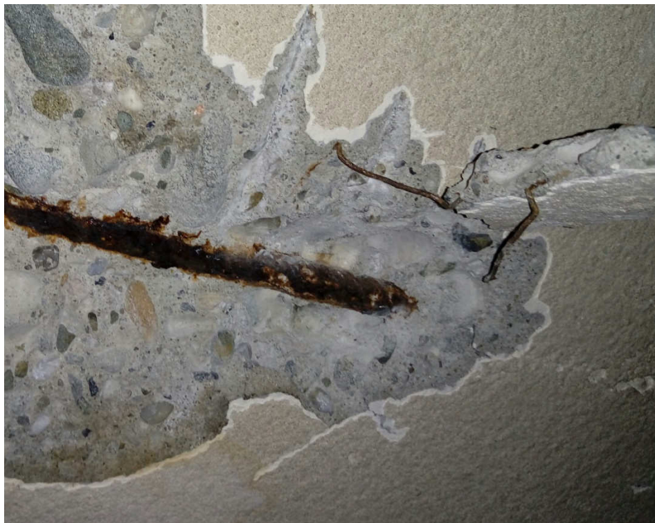
Zdjęcie 3 – Odkrywka zbrojenia
